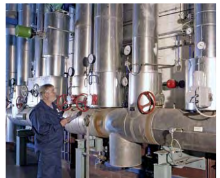
Vor der Verteilungsanlage des Fernwärmenetzes: Evonik-Mitarbeiter Joachim Schulz, Foto: Evonik
